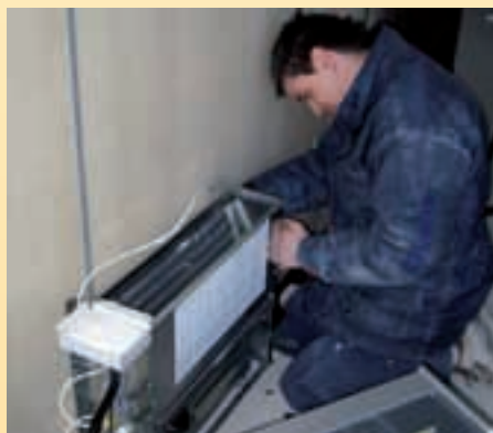
Trece fancoils, cada uno con su propia regulación, permiten la climatización individual de las diferentes dependencias.
