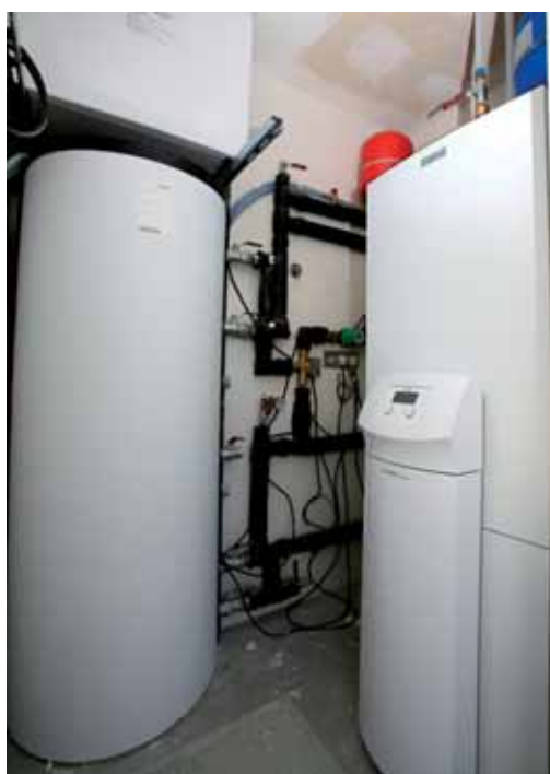
Bomba de calor geotérmica junto al acumulador multi-energía y el sistema de ventilación mecánica controlada
