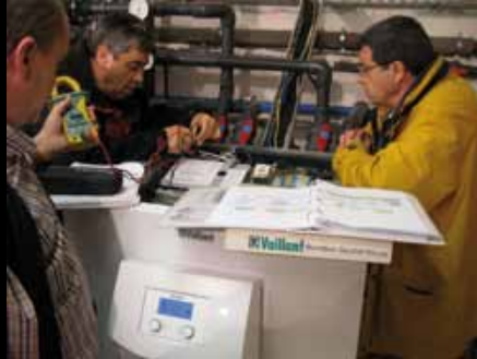
Los técnicos de Vaillant realizan la puesta en marcha del sistema
