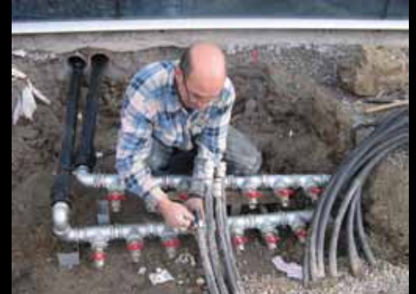
Conexionado a colectores junto al acceso de la captación al interior, donde se instalará la bomba geotérmica
