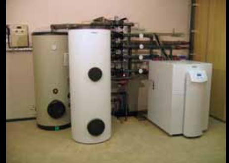
Bomba geotérmica, acumulador y depósito de inercia conforman el núcleo de la instalación descrita
