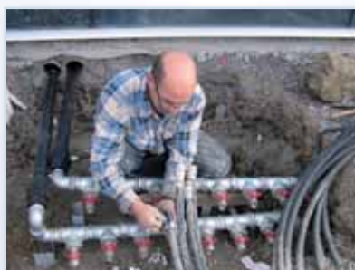
Conexionado a colectores.
