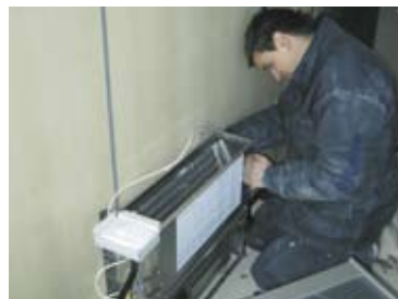
13 fancoils, cada uno con su propia regulación, permiten la climatización individual de las diferentes dependencias
