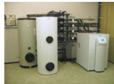
Bomba geotérmica, acumulador y depósito de inercia conforman el núcleo de la instalación descrita
