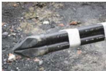
Extremo de uno de los colectores geotérmicos mediante los que se realiza el intercambio de calor (sondas de doble U, compuestas por cuatro tubos y sus correspondientes uniones)
